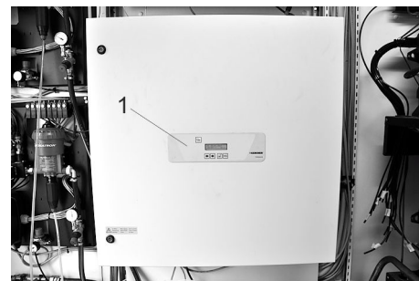
1 Störningsindikering på styrningens display
