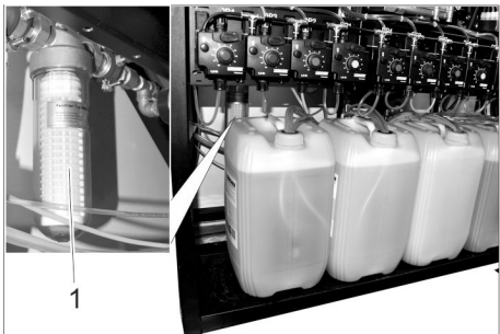
1 Filtre de la pompe antigel
