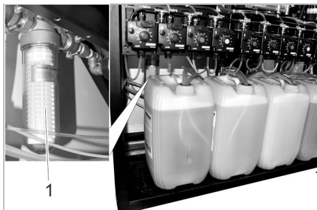
1 Filtre de la pompe antigel
